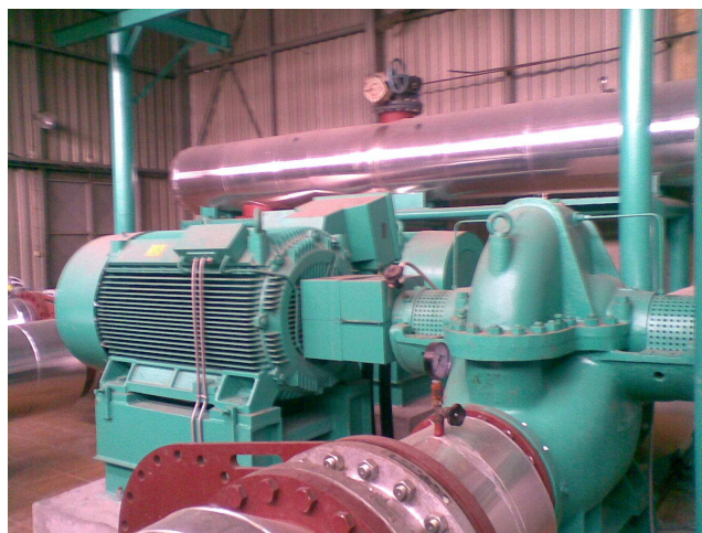
Slika 5. Asinhroni motor snage 400kW koji pogoni cirkulacionu pumpu u Toplani.
